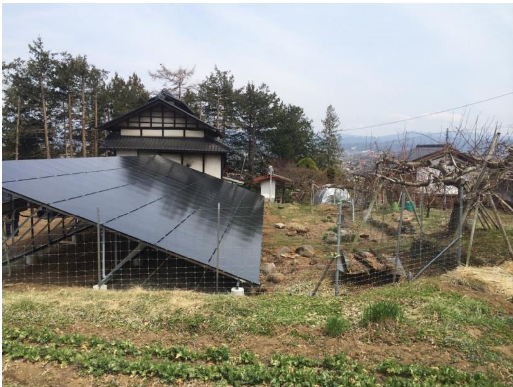
高1550mmのフェンスに2段のフェンシングワイヤー 景観に配慮し有刺鉄線は使用せず、フェンシングワイヤーを使用 長野県佐久市にて
